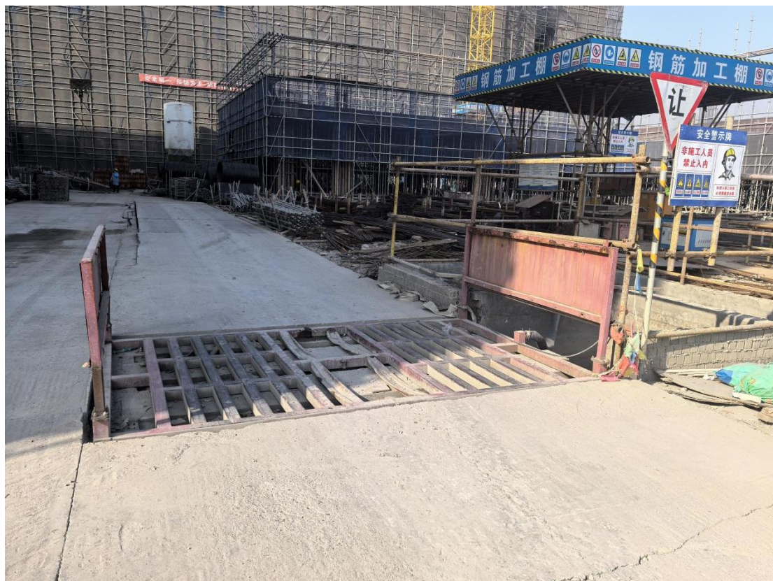
图3.5-1 项目已有措施图（洗车平台）
